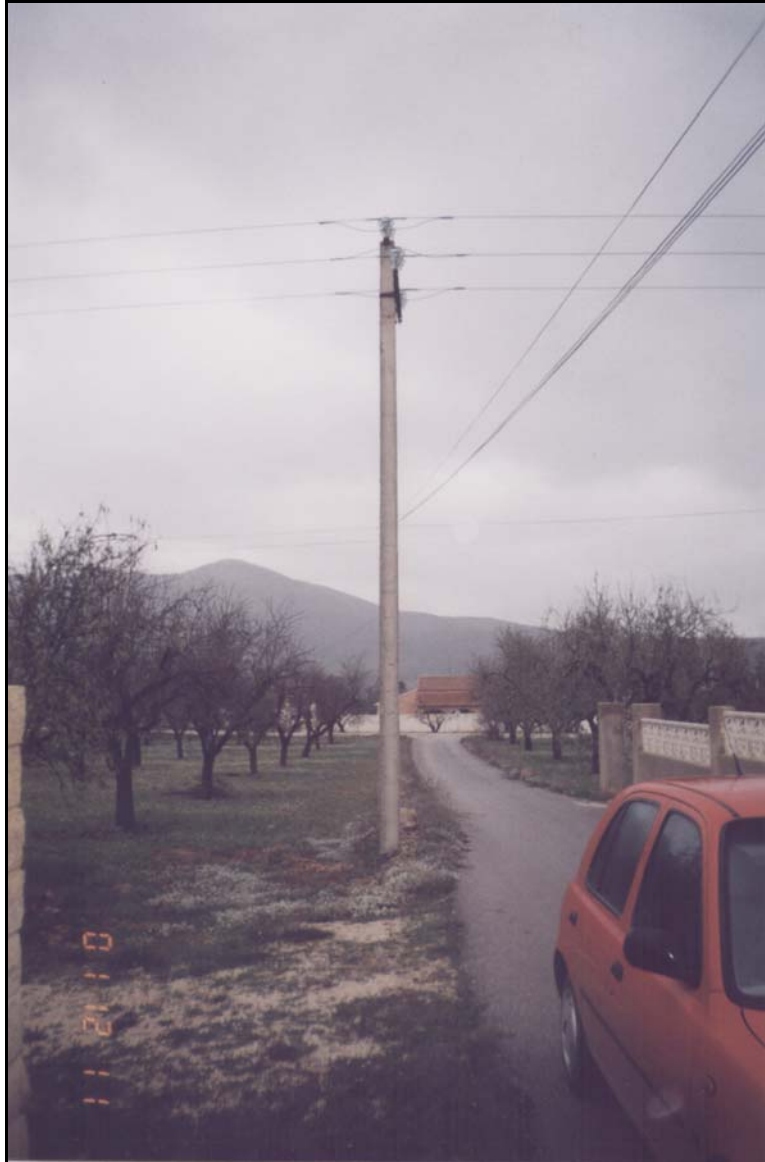
FOTO 1: TORRE DE MEDIA TENSIÓN DESDE LA QUE SE REALIZARÁ LA CONEXIÓN AÉREO-SUBTERRÁNEA.
