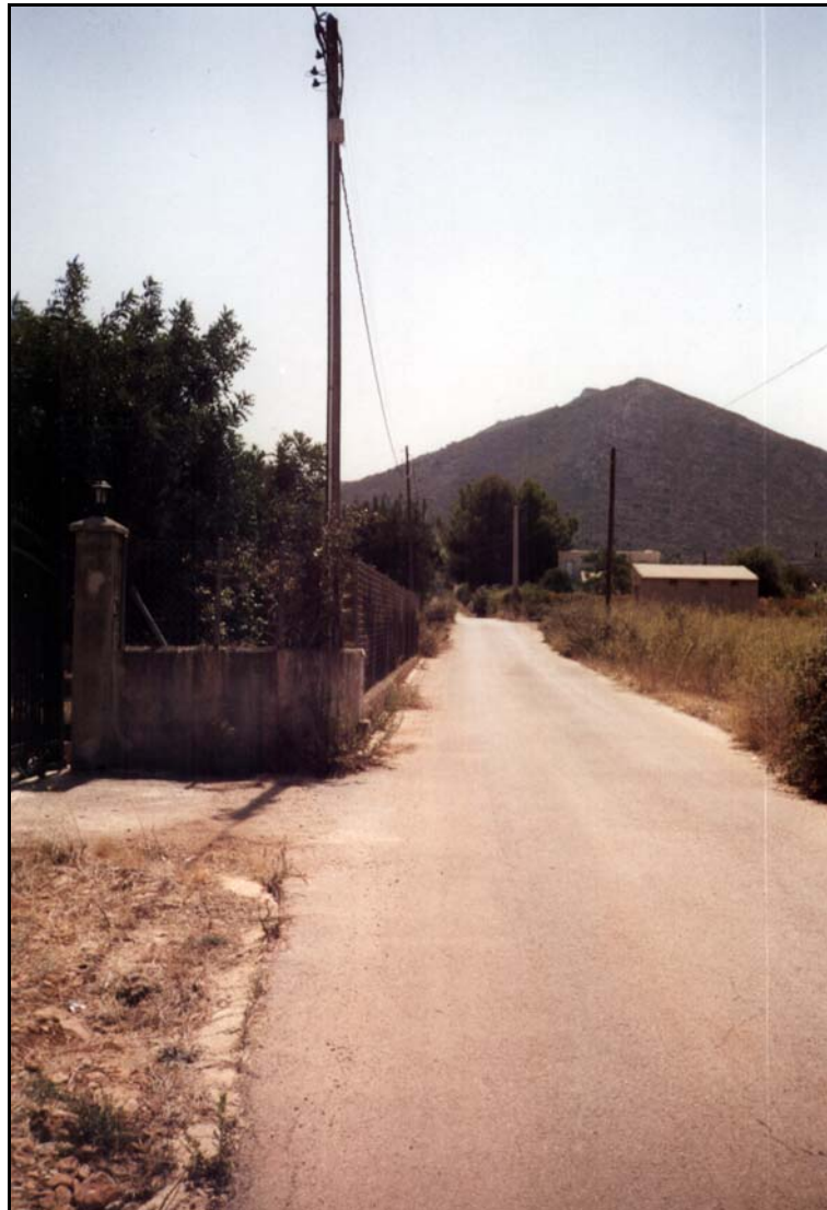
FOTO 15: VALLADO Y POSTE A REPONER. VISTA CAMINO HACIA ATRÁS, PK 0+320. PUERTA DE ENTRADA A TRANSLOCAR.
